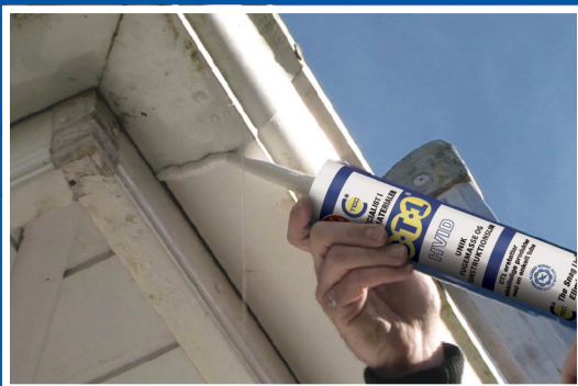
Hurtig reparation af lækken af afløb
